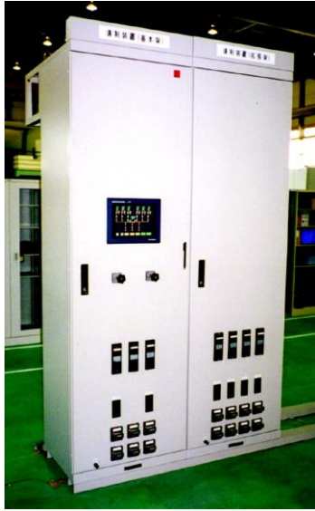
遠方監視制御装置
